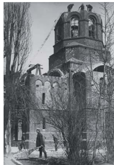
Warszawa. Rozbiórka cerkwi przy szpitalu Dzieciątka Jezus FOT. NARODOWE ARCHIWUM CYFROWE (WWW.NAC.GOV.PL)
